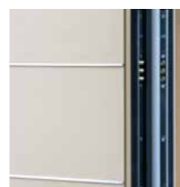
Passage de câble
